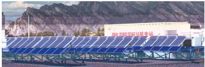
高性能鉛炭電池儲能項目
